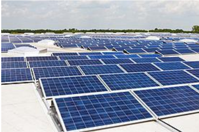
Fig. 9: Solar PV modules
